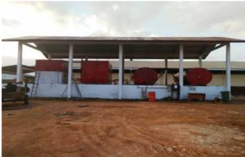
Gambar 4. Tangki BBM yang terlindungi
